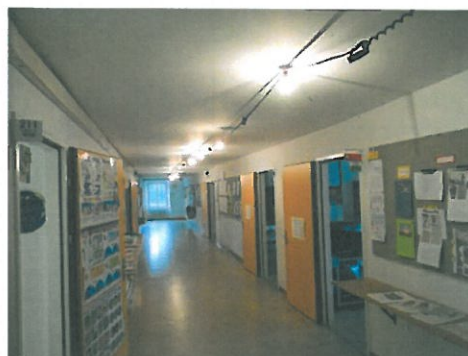
仮照明が設置された2階廊下
